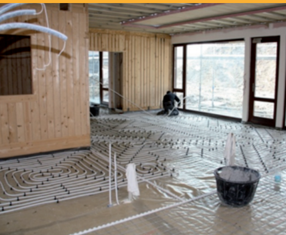
Circuits de chauffage au sol – Crèche «Les Jeunes Pousses» Source : Atelier d'Architecture DDV
